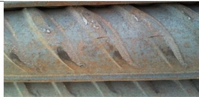
شکل ۳ ترک روی آج میلگرد قطر ۳۲
